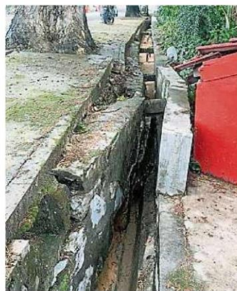
排水沟被泥水冲刷后,出现损坏及堵塞问题。
